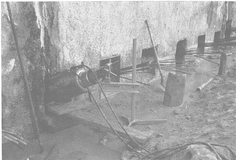
Fig. 5. — Port Autonome du Havre. Essai de mise en tension de l'un des tirants de la darse de l'Océan (1976).
