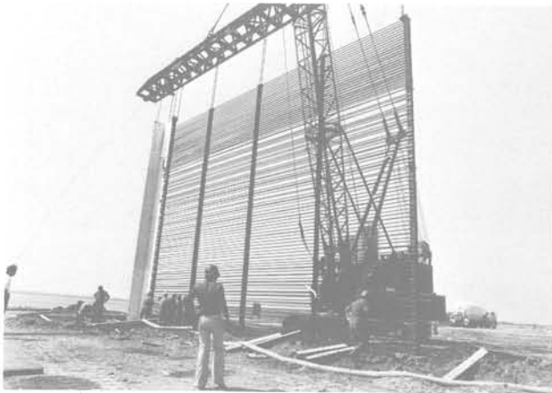
Cliché n° 5 Descente d'un élément d'armature tirant avant, avec pièce de tête et pièce de raccord femelle
