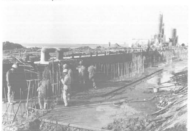
Cliché n° 8 Coffrage et bétonnage de la poutre de couronnement du quai
