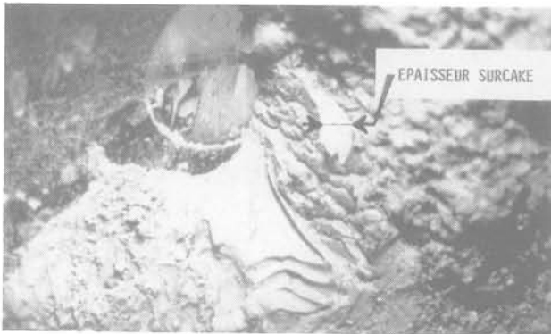
Fig. 13. — Le surcake s'affaisse sous son propre poids lorsqu'il n'est plus déjaugé par la boue. (Photographie prise à l'intérieur du caisson après vidange de la boue).
