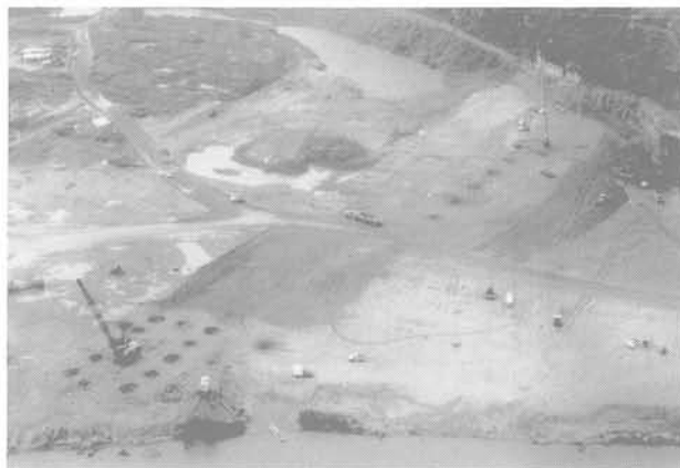
Fig. 11. — Vue générale du site : au premier plan le bras de droite du Grijalva, puis l'atelier de consolidation dynamique avec une grue, enfin l'atelier du tripode sur le bras de gauche du fleuve remblayé.
