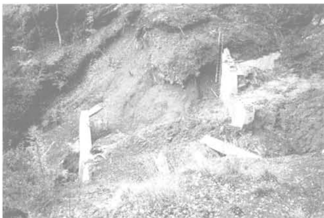
FIG. 1 Action d'une berge instable sur un barrage de correction torrentielle de type consolidation.
