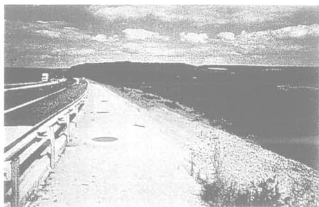
FIG. 7 Vue générale du site en 2000. Landslide after road works in 2000.
