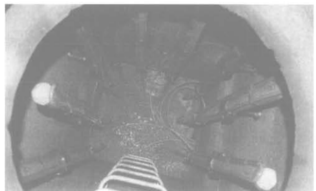
FIG. 2 Vue sur regard exutoire avec chasses automatiques. Outlet manhole with automatically regulated flushing system.
